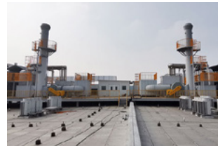
杭州ヤマハのVOC処理施設
