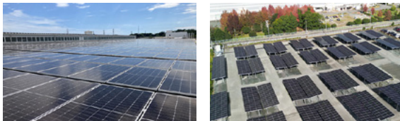
掛川工場に設置した太陽光発電設備
