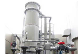
本社事業所の地下水浄化装置
