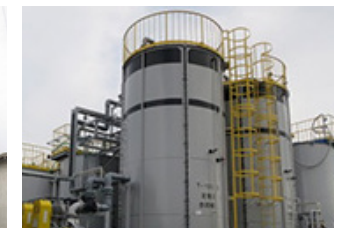
豊岡工場の廃水処理設備
