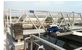
廃水を冷却水などに再利用(杭州ヤマハ)
