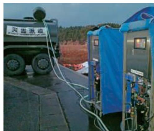
能登半島地震におけるアクアレスキューの設置
